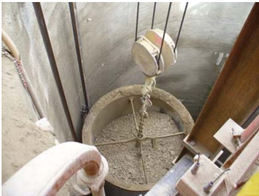
Schachtförderkübel im Aufzug
